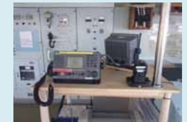
VHF無線機・測深機
